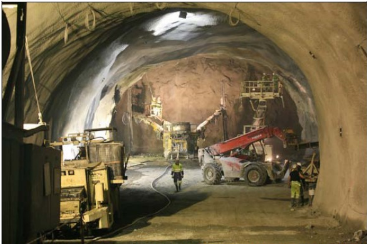
Les travaux du tunnel Lyon-Turin ont démarré côté français (photo : Transalpine - Jean-Luc Rigaux)
